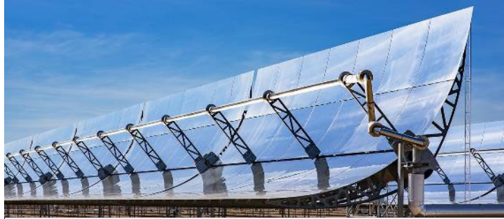
Sistemas Solares Térmicos
