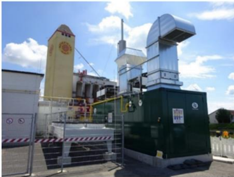
Figura 65: INNIO & Hansewerke AG (2020).).
